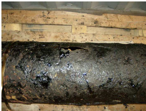
Brèche en cause (fissure de 16 x 1 cm)
